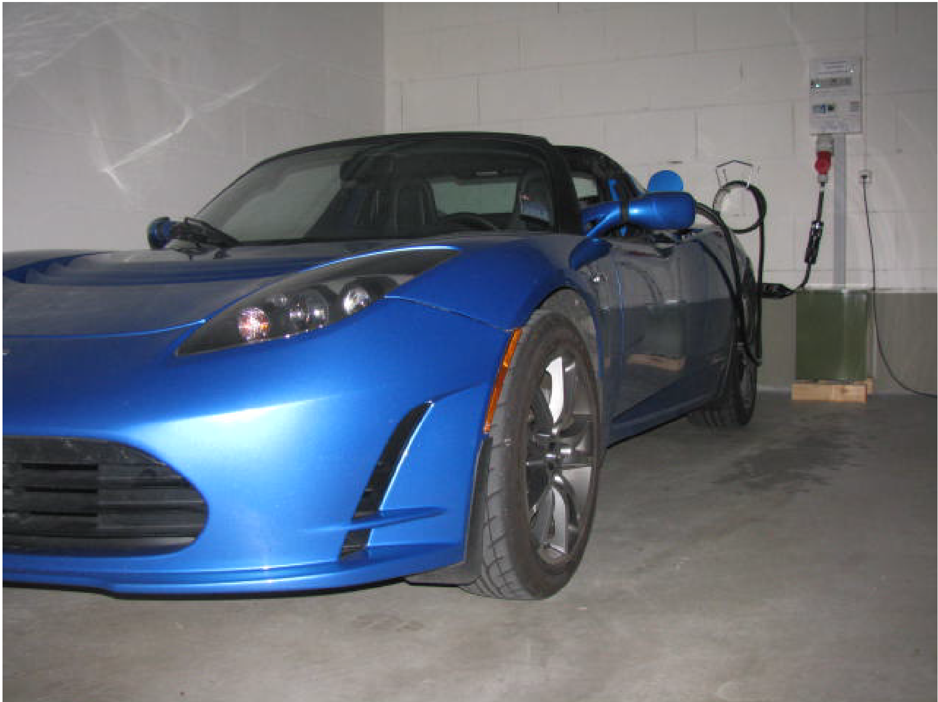
Gesamtbild Tesla Roadster an Ladestation 32A mit Steuertableau, Trenntransformator, Steckdose 32A, Tesla Ladekabel
