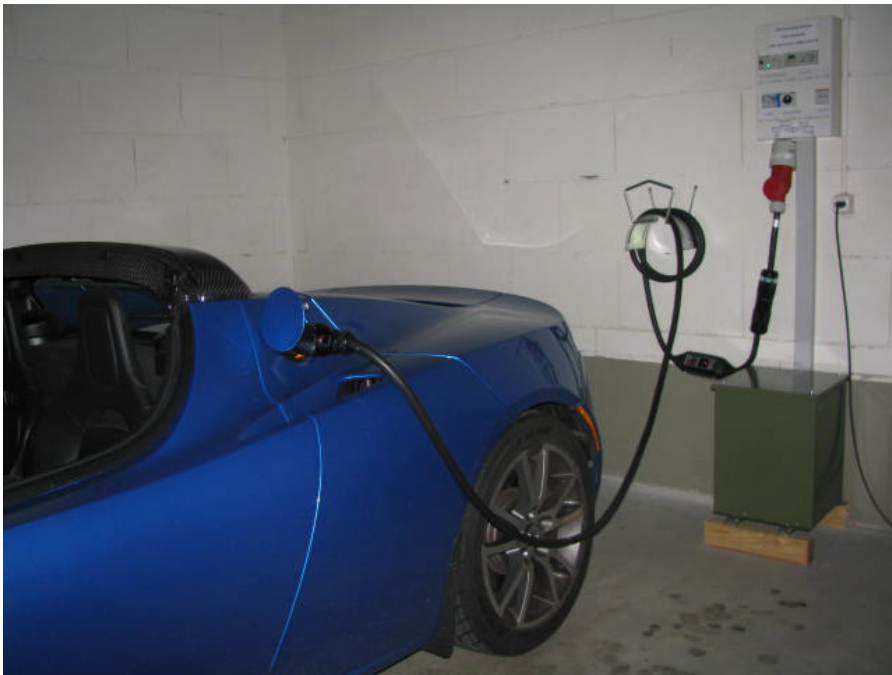
Tesla Roadster, Ladestation (Trafo, Steuerung, 32A Steckdose)
